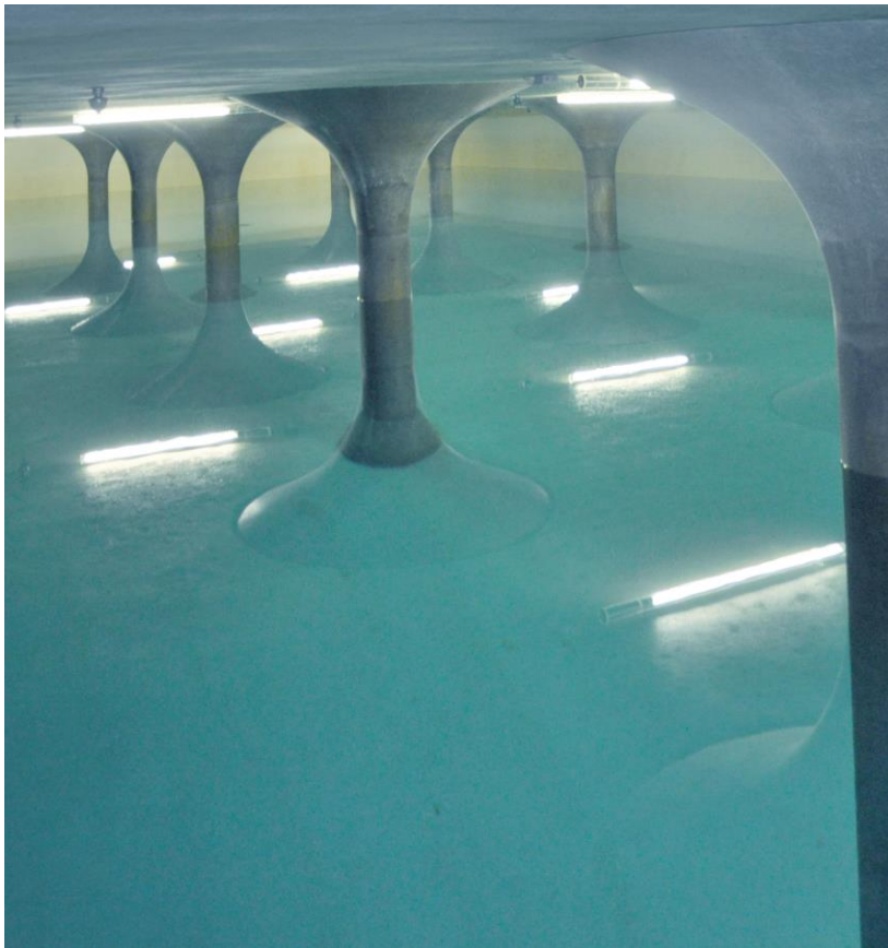
Bild: Reservoir Rebberg, Zofingen
