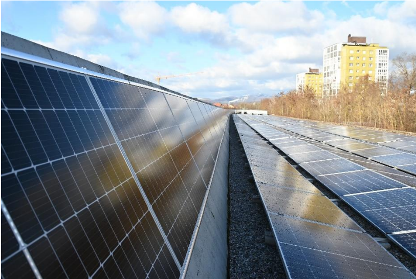
Die gemeinschaftliche Photovoltaikanlage auf der Autobahn-Halbüberdachung A2 zwischen Zofingen und Strengelbach.
