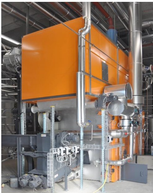
Die Fernwärmezentrale im Spital in Zofingen, welche 2017 in Betrieb genommen wurde.
