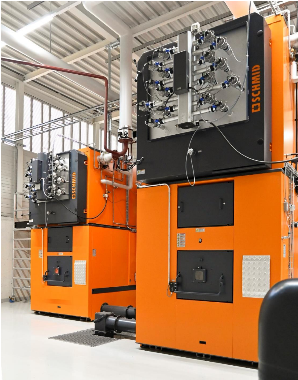
Bildlegende: Das Herzstück der Energiezentrale - die beiden Holz-Heizkessel.
