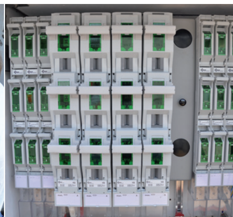
Verteilkabine nach Sanierung.
