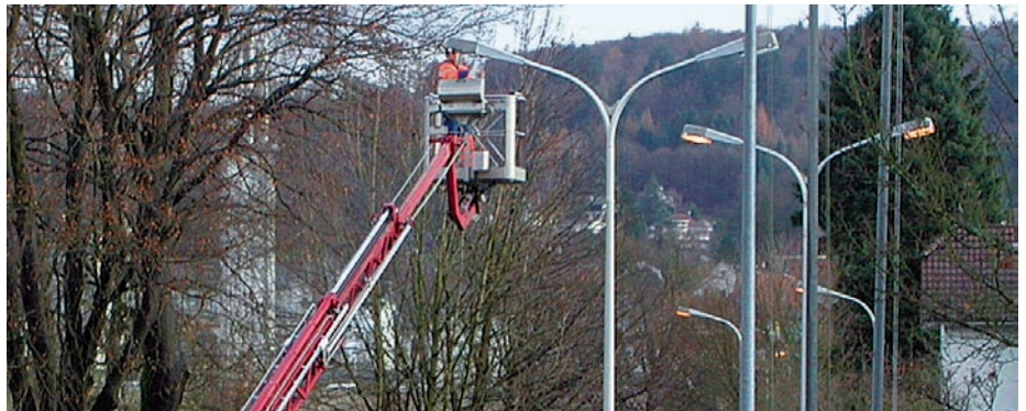
Monatliche Strassenlampenkontrolle der StWZ Energie AG
