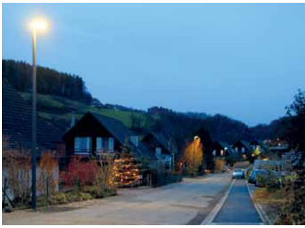
Bild: Die neuen LED-Strassenleuchten an der Weidstrasse
